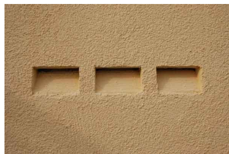
Abb. 4: in Hauswand eingebaute Kästen
