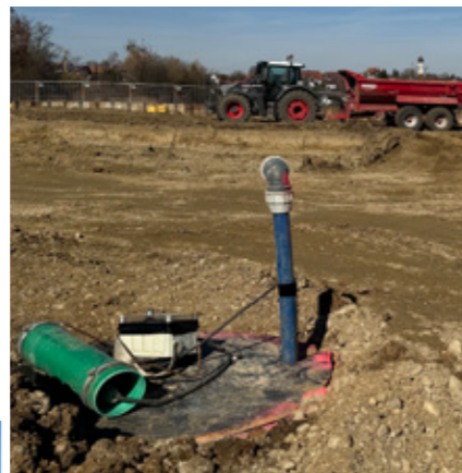
► Eine von vier Pumpen zur Entwässerung des Geländes
